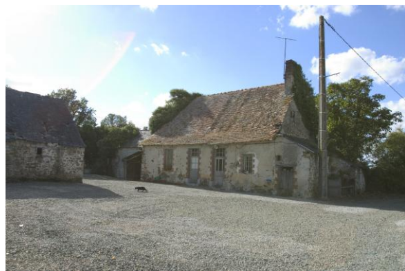
Fig. 2 - Logis du 16 e ou du 17 e siècle dont les ouvertures ont été agrandies et encadrées de briques au 19 e siècle : le Mortier à Vaiges. © Inventaire général, F. Lasa.
