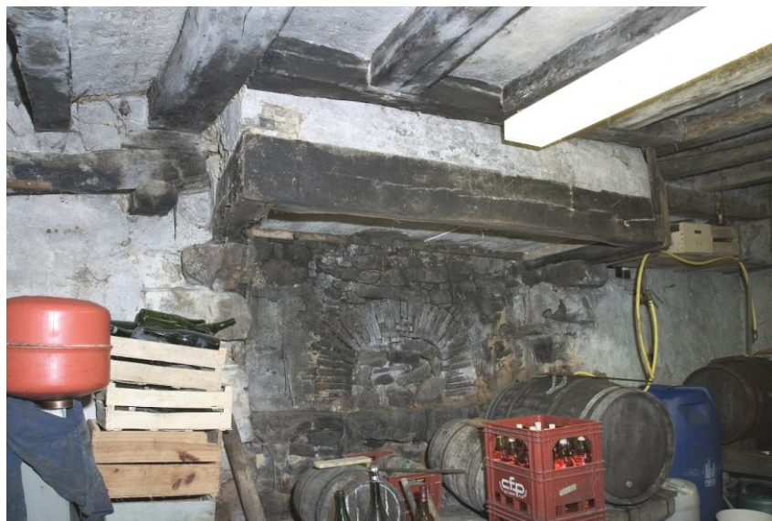
Fig. 11 - Poutre de rive sur corbeaux, corbeaux de cheminée épais en pierre brute : la Bidaudière à Vaiges. © Inventaire général, F. Lasa.
